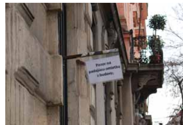
Na viacerých miestach v štvrti sa na fasádach nachádza upozornenie na padajúcu omietku z budovy. Aj tento detail prispieva k pocitu nedostatočnej starostlivosti a podprahovo odrádza od využívania verejných priestorov.
