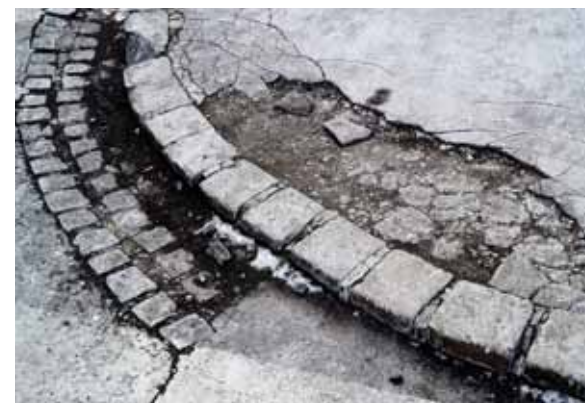
Poškodené chodníky a obrubníkmi sú častým problémom.
